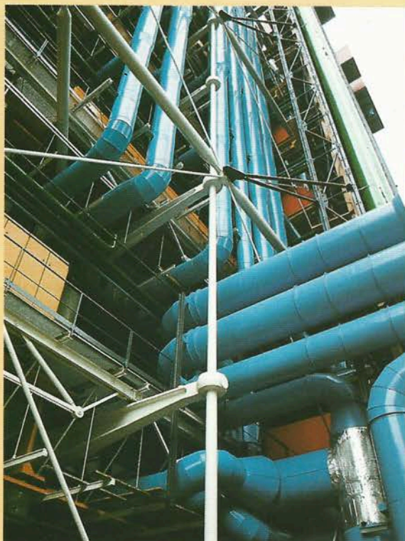
Façade technique avec ses tuyaux apparents. © Remy Poinot/Pix.
